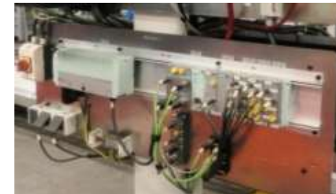
Контроллеры ET200PRO ф. Siemens
